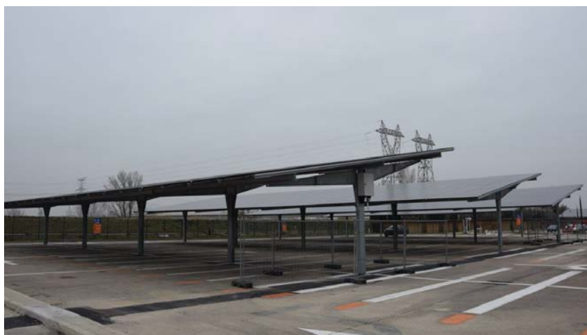
Un exemple de réalisation CORUSCANT : la couverture photovoltaïque des parkings de la gare TGV d'Avignon
